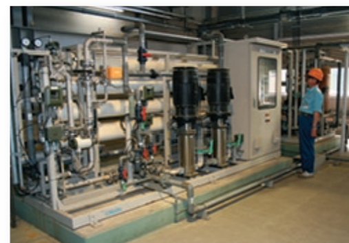
排水から有害物質を取り除く中水化システム。
