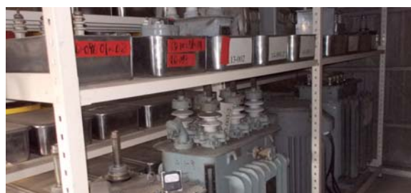
漏洩対策などの措置を行い保管しているPCB含有廃棄物保管庫
