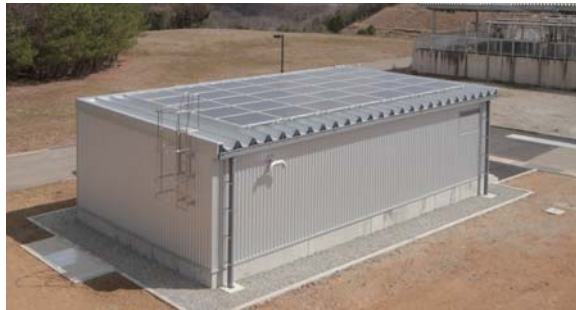
真空排水施設太陽光発電設備
