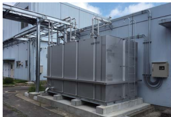
実験排水処理のための中継槽
