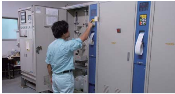
水質自動監視装置
