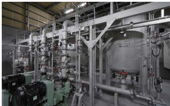
真空排水施設機械設備
