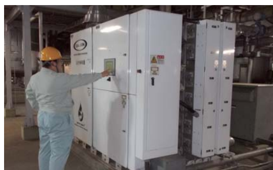
排水から有害物質を取り除く中水化システム
