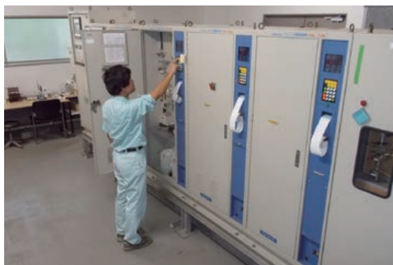
水質自動監視装置
