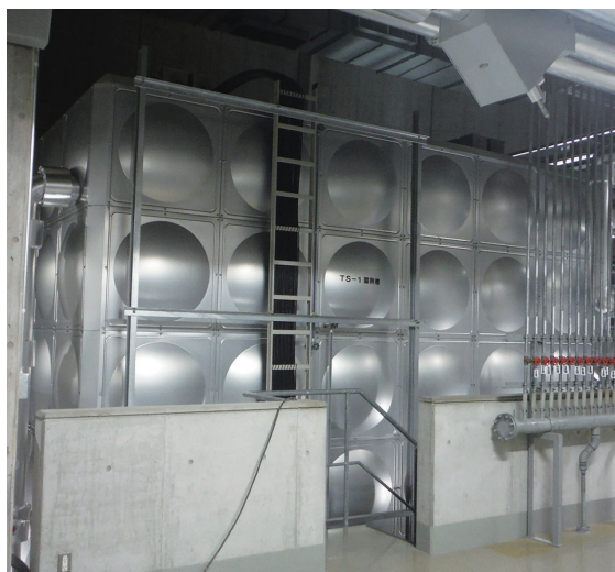
蓄熱槽 蓄熱容量:1.2GJ 2次ポンプ:6,000L/分
