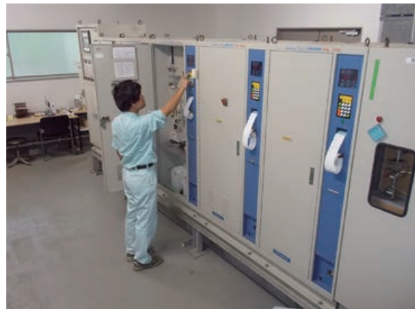
水質自動監視装置
