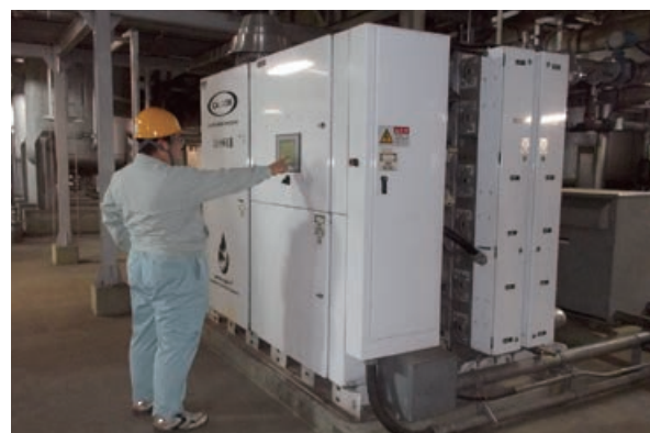
排水から有害物質を取り除く中水化システム
