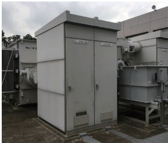
筑波地区構内へ電気の供給を行う特別高圧受変電設備
