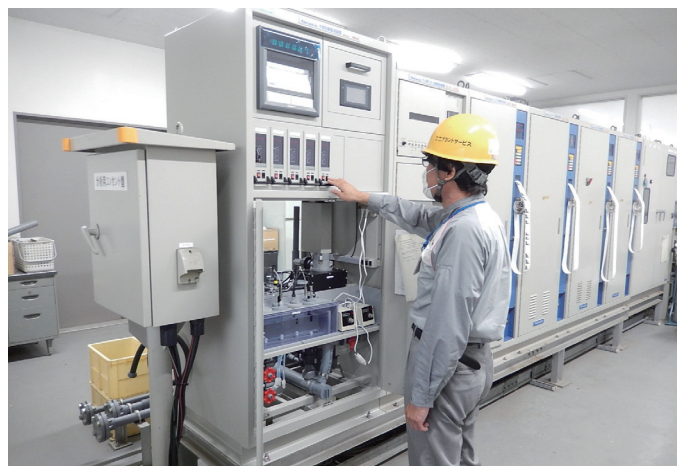
■水質自動監視装置
