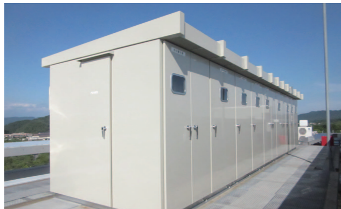
■構造生物学研究棟受変電設備
