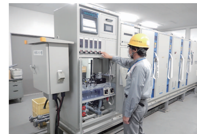
■水質自動監視装置
