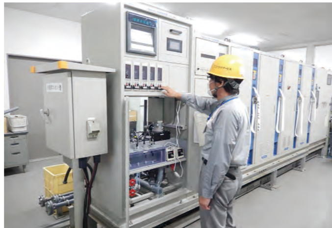
■水質自動監視装置
