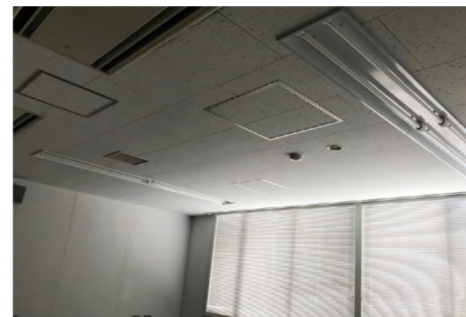
③照明器具LED化前
