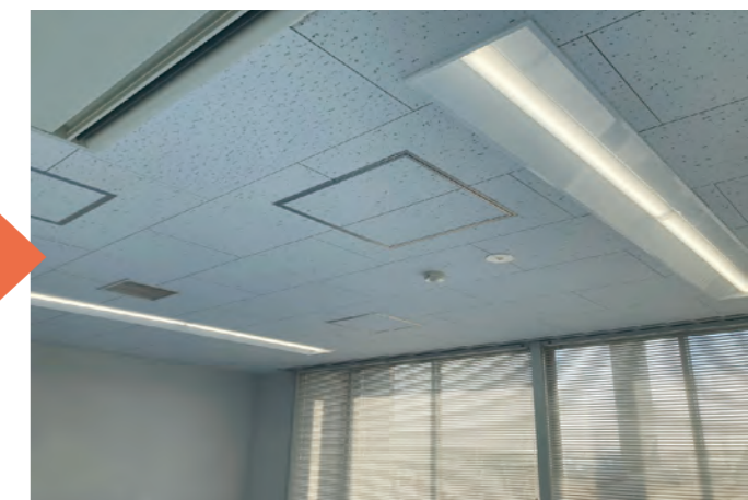
④照明器具LED化後
