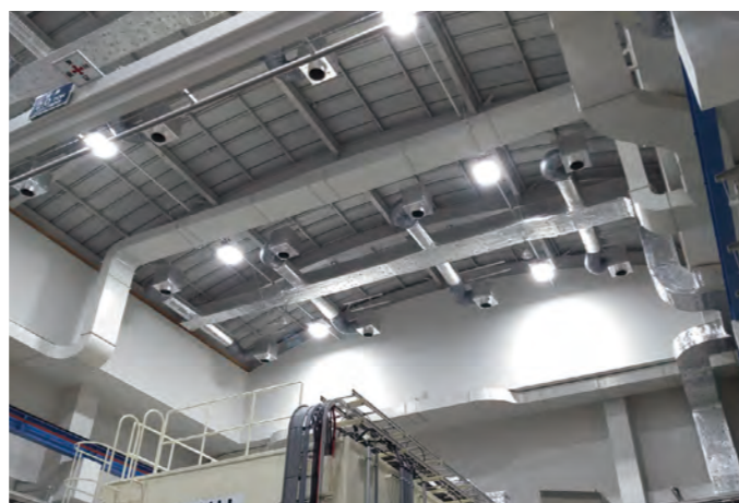
長尺ビームライン実験施設高天井照明
