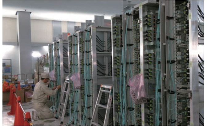
図3 ラックの設置が進む「富岳」(2019年12月18日撮影) 「京」が稼働していたスペースに、最終的に400台以上のラックが設置される。
