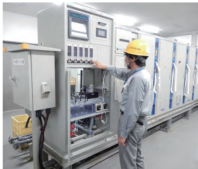
水質自動監視装置
