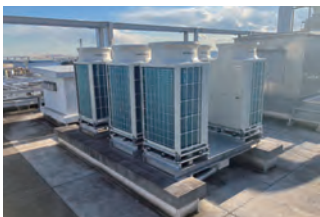
閉鎖系温室室外機更新後
