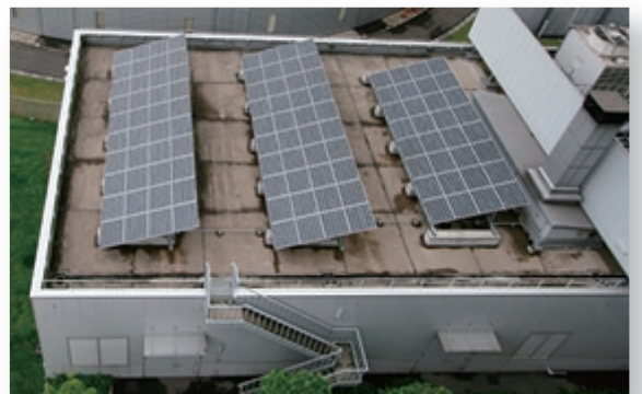
横浜研究所の各棟に設置された太陽光発電パネル。
