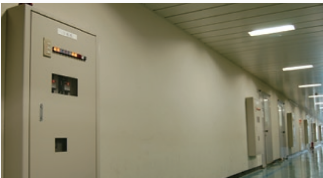
各部屋に設置された電力の計測機能を備えた実験用分電盤。
