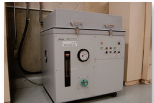
排気中の放射性物質濃度を測定する排気モニタ。
