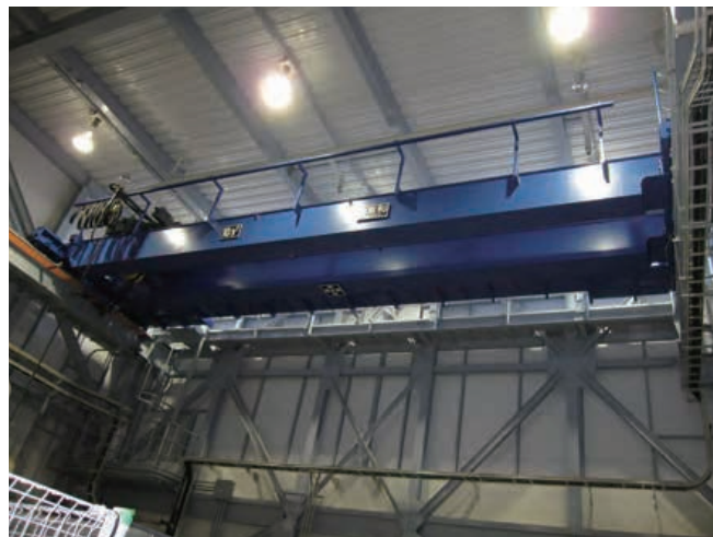
施設内のクレーン
