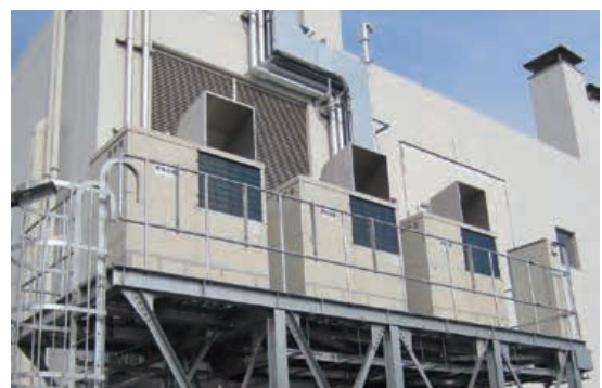
コージェネレーションシステム
