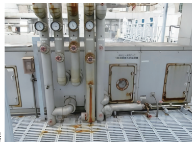
更新前の空調機器
