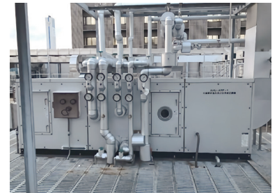
更新された空調機器
