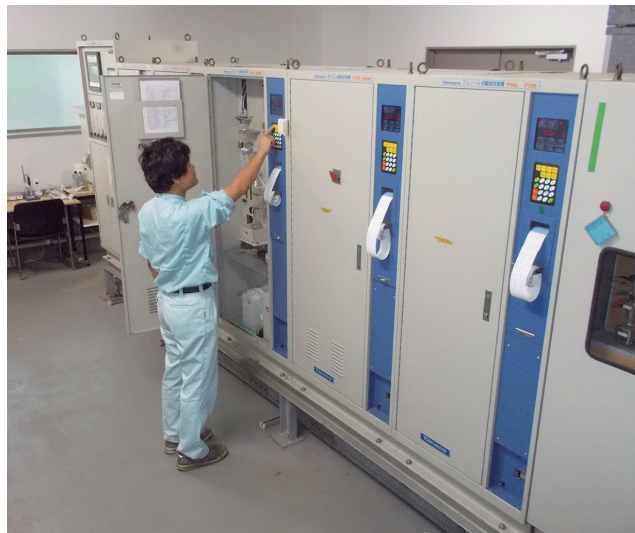
■水質自動監視装置
