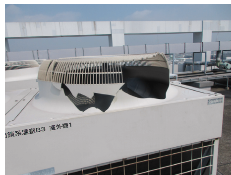
屋外にある室外機の破損
