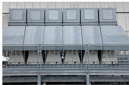
空冷チラー設備
